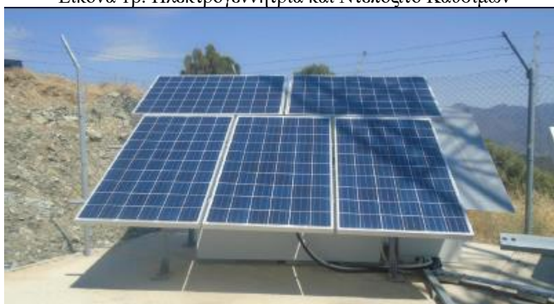
Εικόνα 1γ: Φωτοβολταϊκά Πλαίσια
