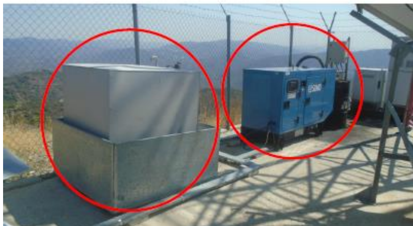
Εικόνα 1β: Ηλεκτρογεννήτρια και Ντεπόζιτο Καυσίμων
