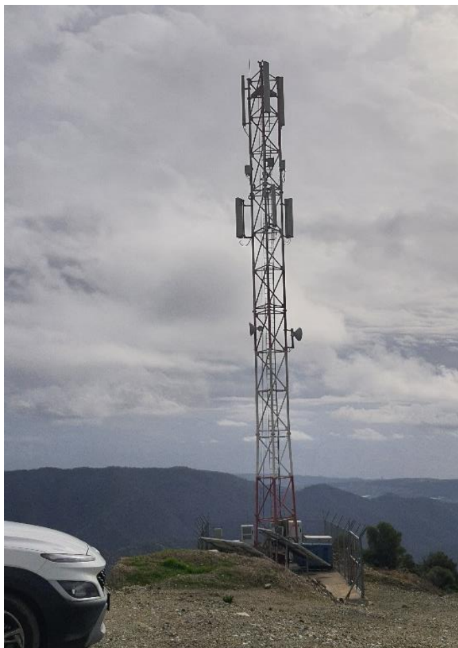
Εικόνα 1α: Σταθμός Βάσης Κινητής Τηλεφωνίας
