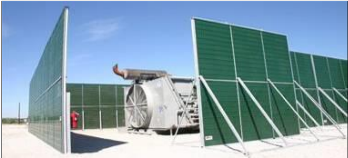
Εικόνα 10-2: Χρήση ηχοπετασμάτων σε σταθερές πηγές θορύβου
