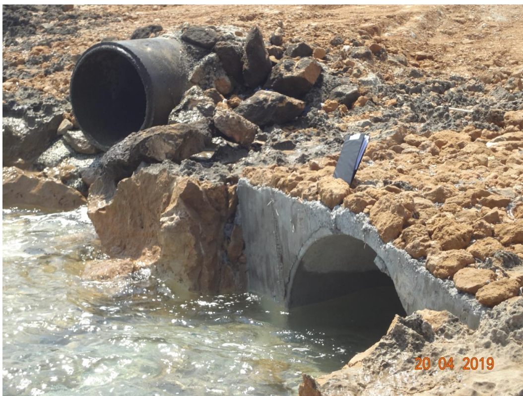
Φωτογραφία 17: Οι υπόγειοι αγωγοί εκτροπής του αργακιού που εκβάλλουν στη θάλασσα
