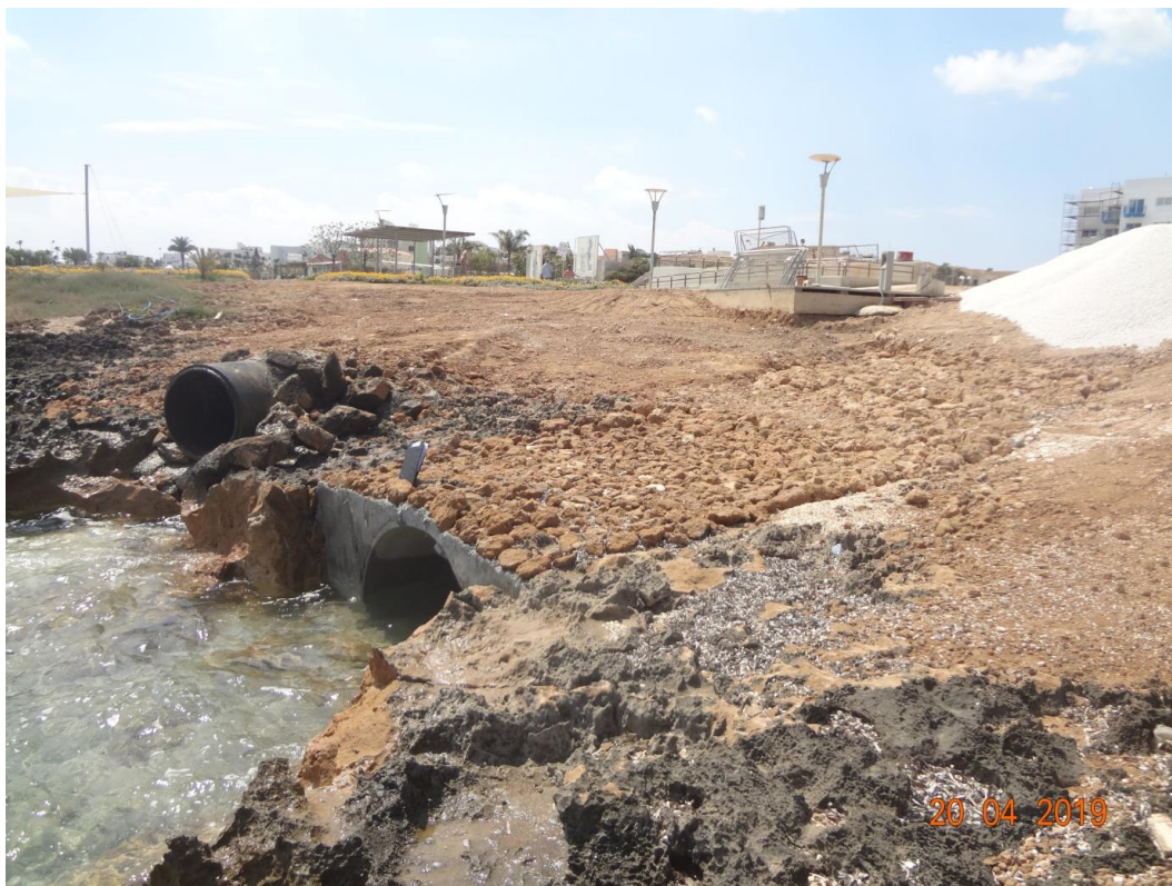
Φωτογραφία 16: Οι υπόγειοι αγωγοί εκτροπής του αργακιού που εκβάλλουν στη θάλασσα
