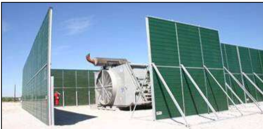
Εικόνα 4: Χρήση ηχοπετασμάτων σε σταθερές πηγές θορύβου
