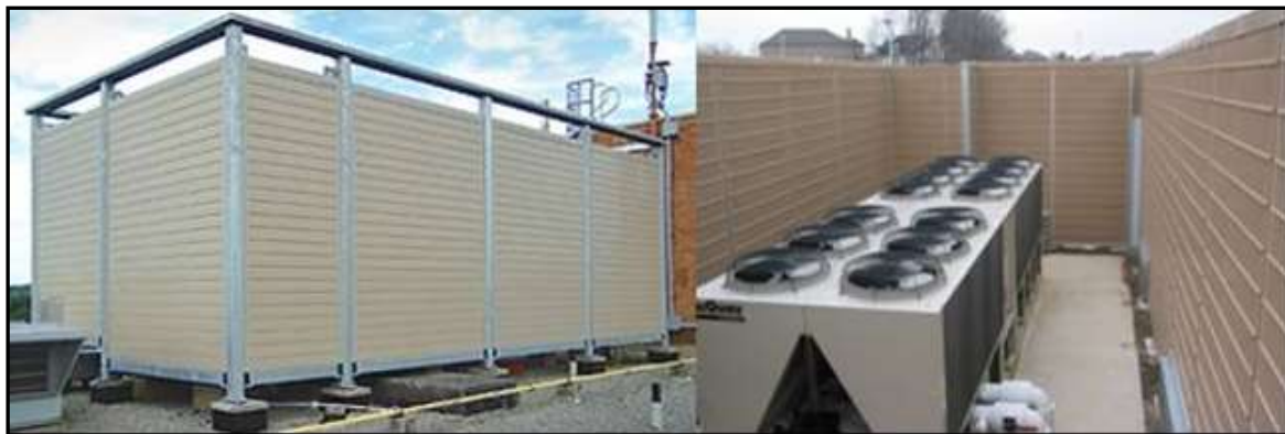
Εικόνα 10: Συστήματα VRV εντός ηχομονωτικής περίφραξης σε οροφή κτηρίου
