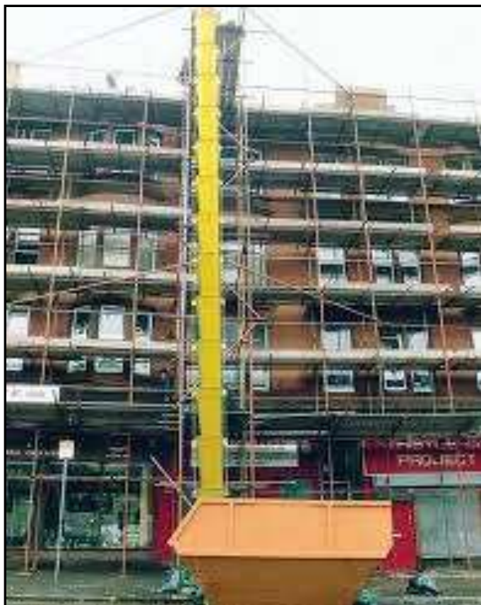
Εικόνα 9:Σωλήνας ρίψης στερεών αποβλήτων από ύψος (Waste chute)
