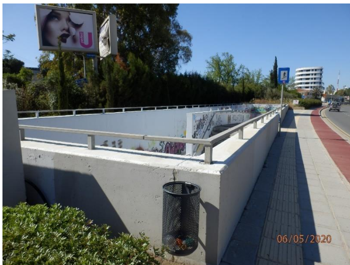
Φωτογραφία 29: Υπόγεια διάβαση έναντι του χώρου του Έργου, επί της λεωφόρου Αγίου Προκοπίου.
