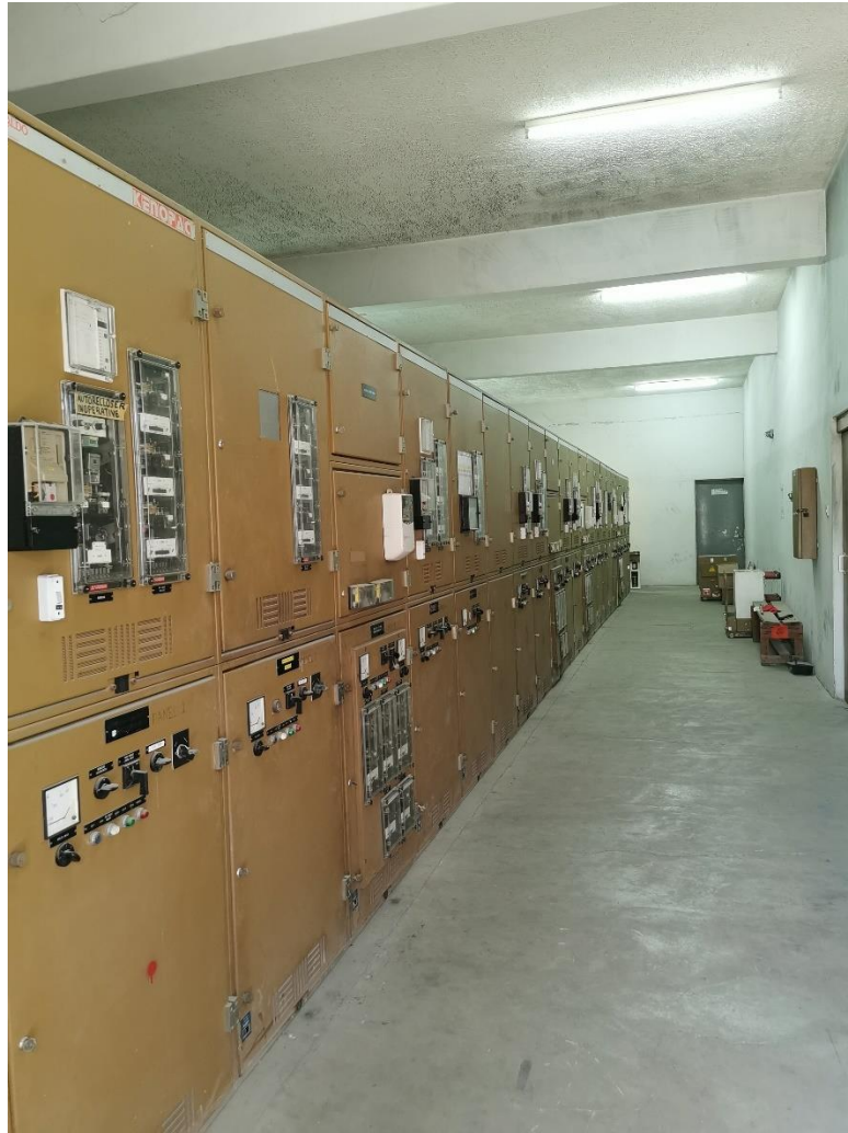
Φωτογραφία 7: Πεπαλαιωμένος εξοπλισμός εντός του υφιστάμενου υποσταθμού
