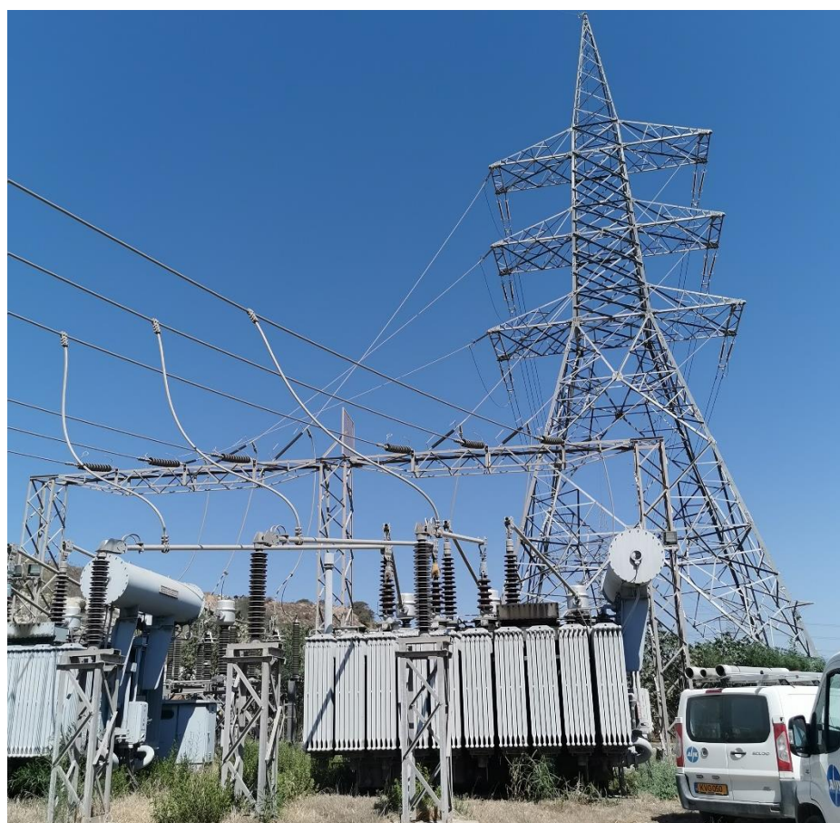
Φωτογραφία 10: Εναέρια γραμμή μεταφοράς υψηλής τάσης – Υφιστάμενοι μετασχηματιστές που θα αντικατασταθούν
