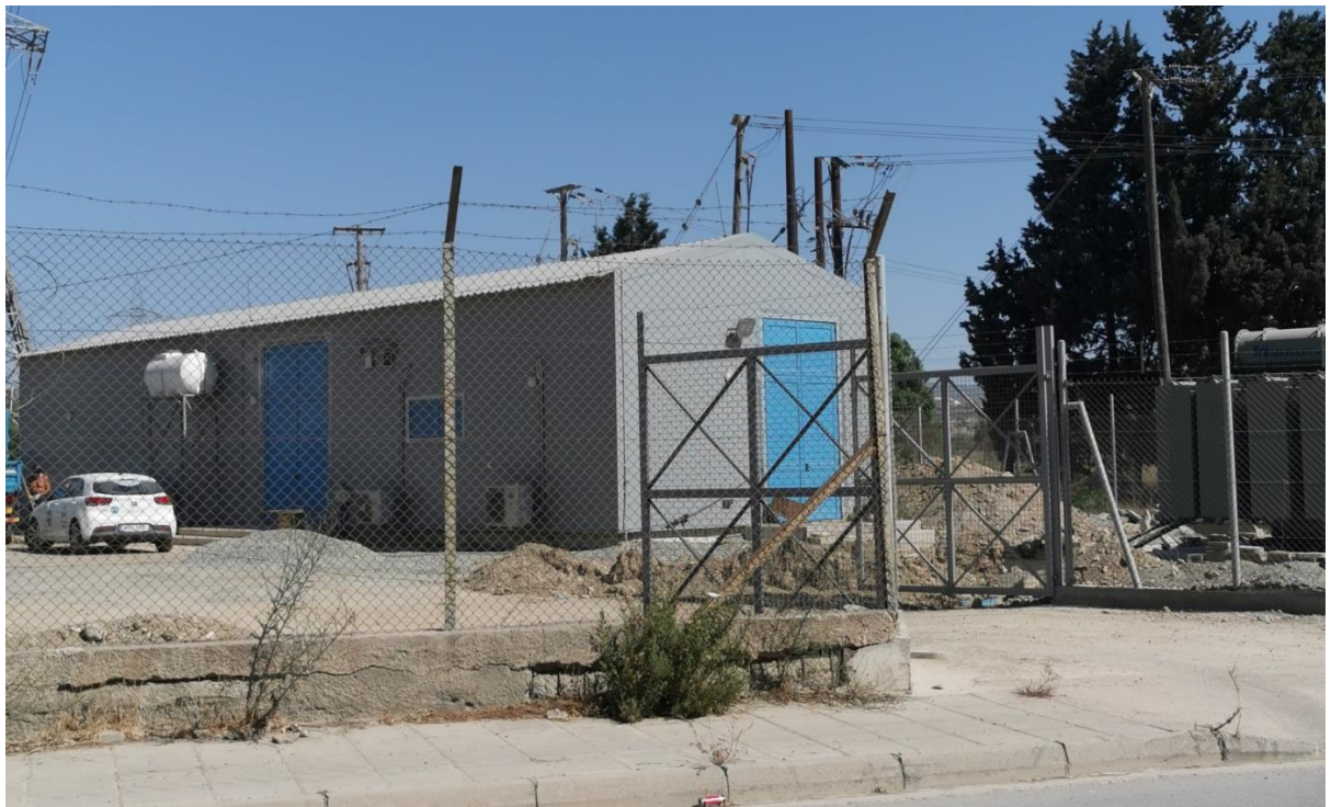
Φωτογραφία 8: Προσωρινός υποσταθμός
