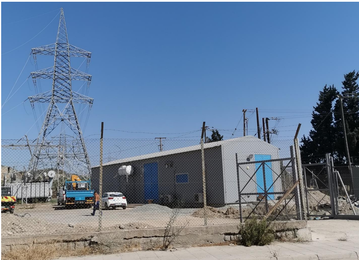
Φωτογραφία 5: Εξωτερική περίφραξη ασφαλείας και προσωρινός υποσταθμός
