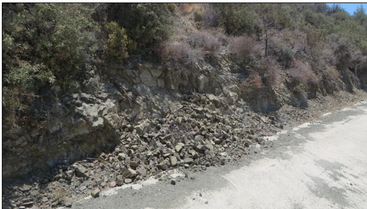
Φωτογραφία 11: Σημάδια κατολίσθησης περιμετρικά του δρόμου πρόσβασης του υπό μελέτη τεμαχίου.
