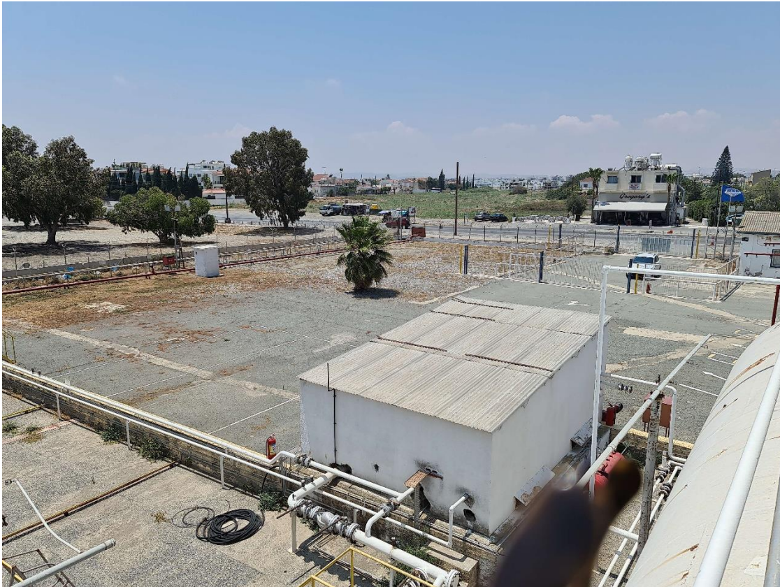
Εικόνα 3-8 Αντλιοστάσιο υγραερίου και δίκτυο υπέργειων αγωγών
