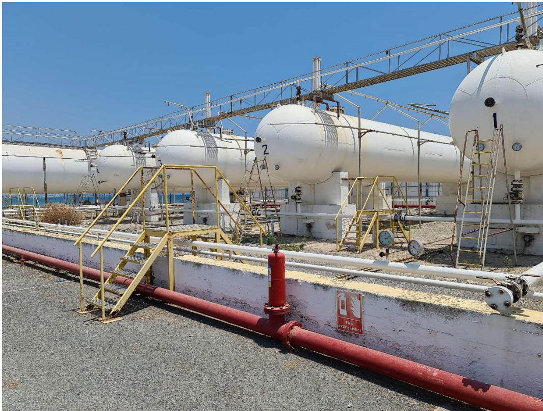
Εικόνα 3-6 Δεξαμενές αποθήκευσης υγραερίου (Αρ. 1 - 2 - 3 - 4 - 5 στην Εικόνα 3.3) που θα αποξηλωθούν
