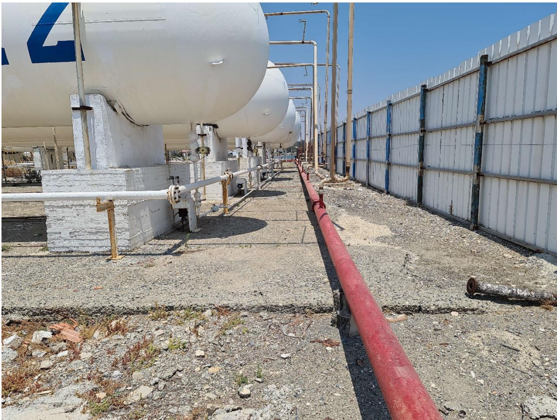
Εικόνα 3-9 Δίκτυο υπέργειων σωληνώσεων (LPG και πυρόσβεσης)
