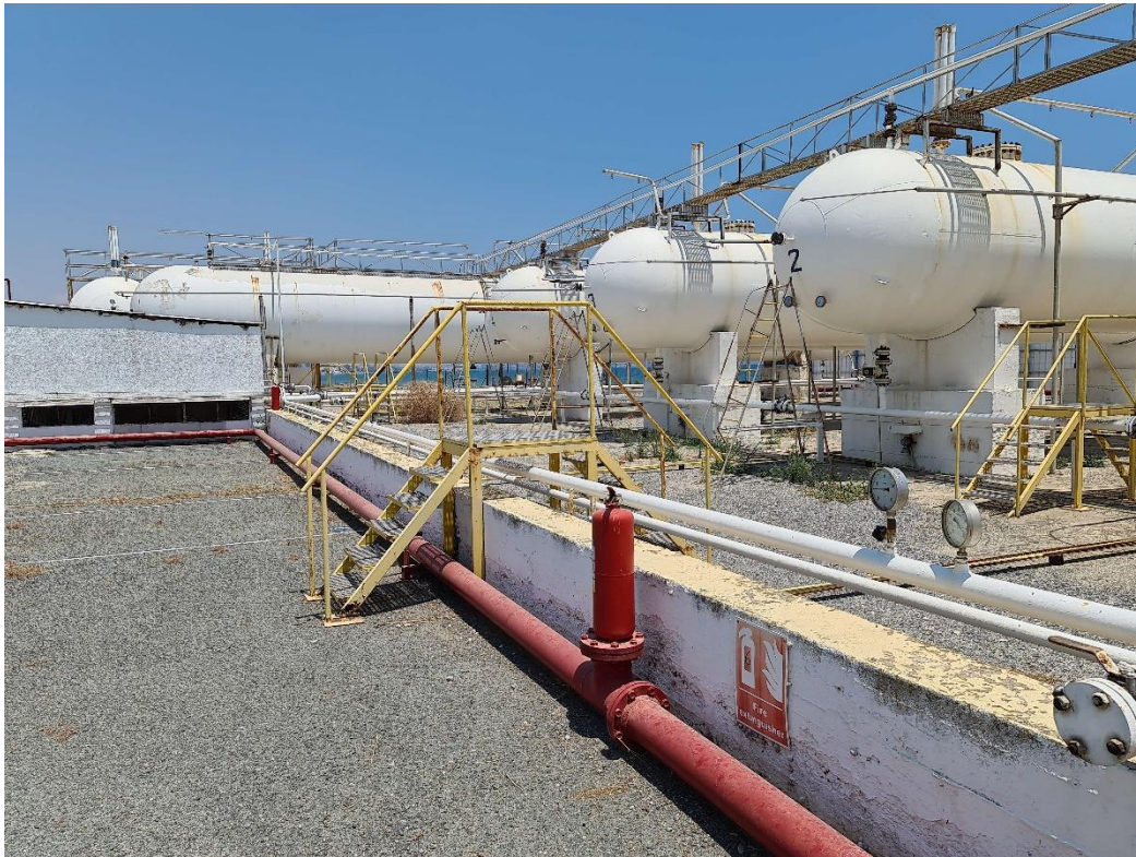
Εικόνα 3-4 Δεξαμενές αποθήκευσης υγραερίου (Αρ. 2 - 3 - 4 - 5 στην Εικόνα 3.3) που θα αποξηλωθούν
