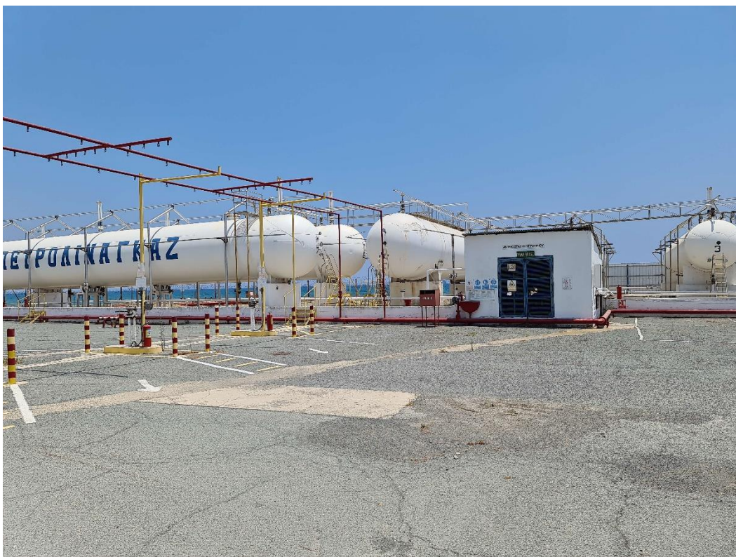
Εικόνα 3-7 Αντλιοστάσιο υγραερίου που θα αποξηλωθεί
