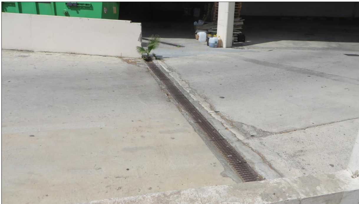
Φωτογραφία 12: Σχάρες που αποτελούν μέρος του συστήματος διαχείρισης όμβριων υδάτων
