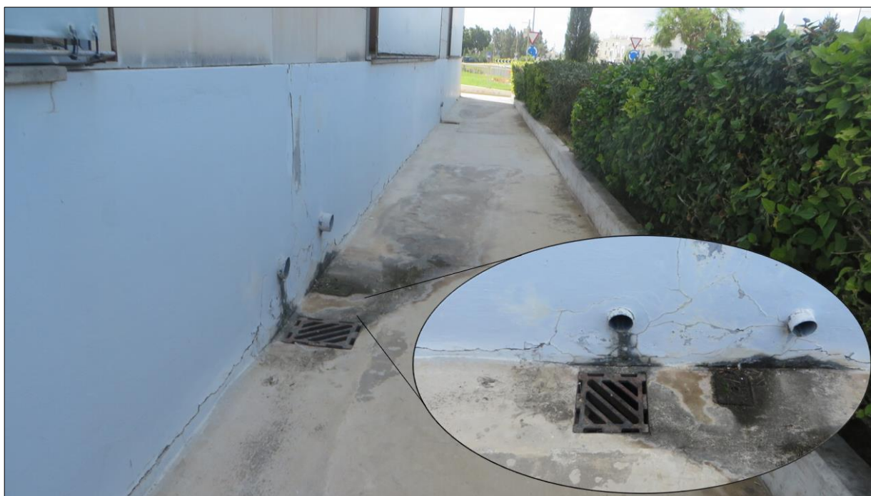
Φωτογραφία 15: Μέρος του συστήματος διαχείρισης όμβριων υδάτων (δυτική πλευρά)
