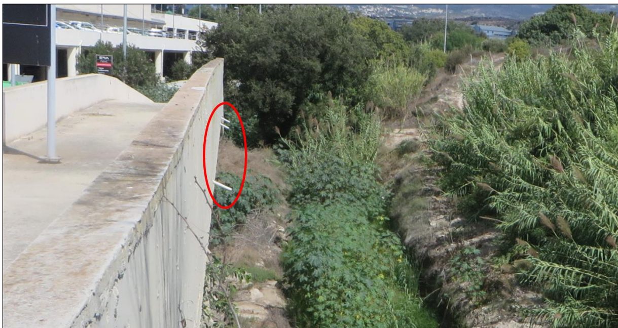
Φωτογραφία 13: Μέρος του συστήματος διαχείρισης όμβριων υδάτων (ανατολική πλευρά)
