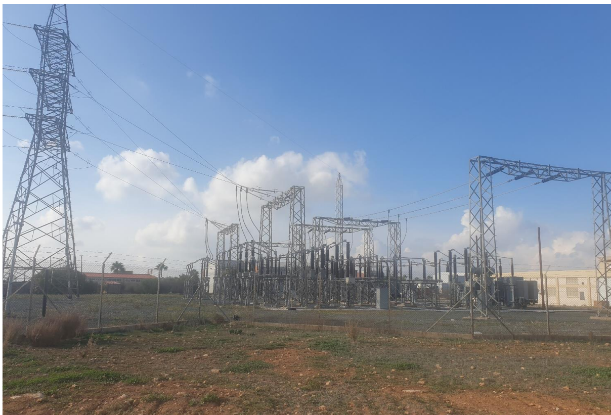
Φωτογραφία 4: Υποσταθμός υψηλής τάσης ΑΗΚ στην άμεση περιοχή του έργου
