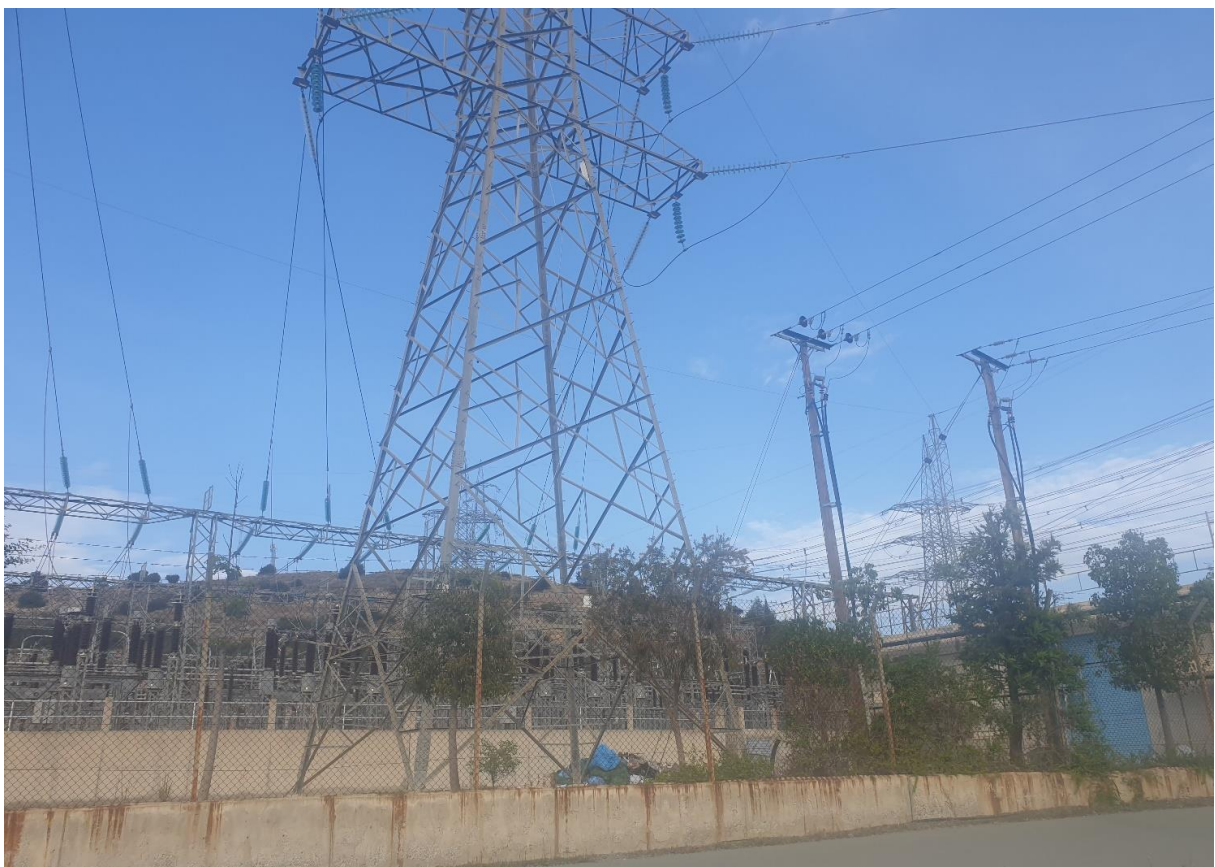
Φωτογραφία 4: Υποσταθμός υψηλής τάσης ΑΗΚ στην ευρύτερη περιοχή του έργου
