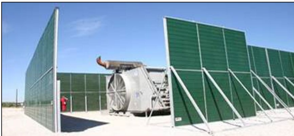
Εικόνα 12: Χρήση ηχοπετασμάτων σε σταθερές πηγές θορύβου
