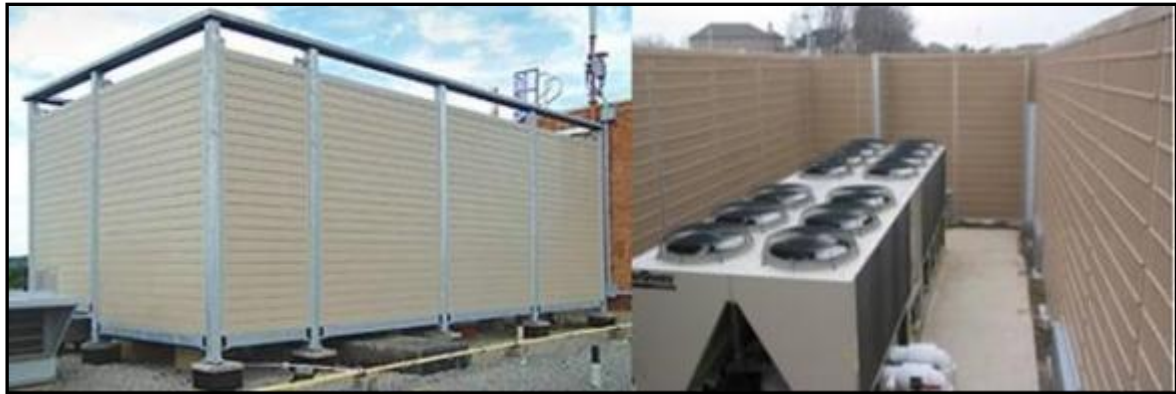
Εικόνα 9: Συστήματα VRV εντός ηχομονωτικής περίφραξης σε οροφή κτηρίου
