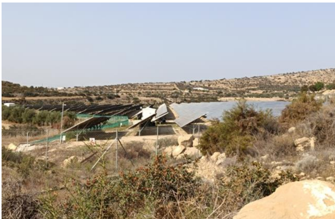
Φωτογραφία 7: Λήψη φωτοβολταϊκού πάρκου νοτιοδυτικά του ΠΕ
