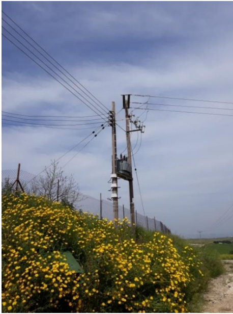
Φωτογραφία 2.2.5: Σημείο σύνδεσης στο δίκτυο της ΑΗΚ – Παροχή Μέσης Τάσης (έναντι τεμαχίου)
