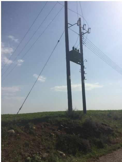
Φωτογραφία 2.2.5: Παροχή Μέσης τάσης πλησίον του τεμαχίου
