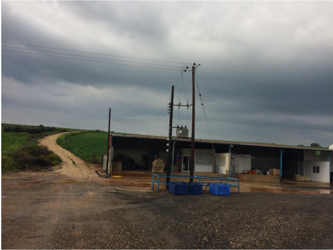
Φωτογραφία 2.2.4: Παροχή Μέσης τάσης πλησίον του τεμαχίου
