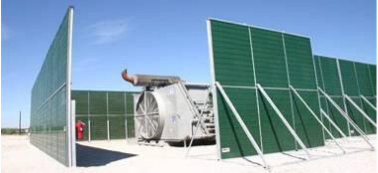
Εικόνα 9-2: Χρήση ηχοπετασμάτων σε σταθερές πηγές θορύβου
