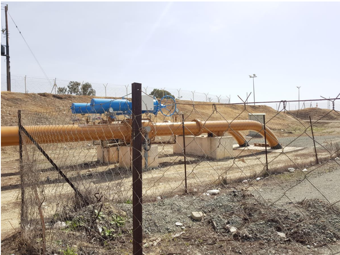
Εικόνα 5.18: Απόληξη στην ξηρά των δύο υποβρύχιων αγωγών μεταφοράς καυσίμων
