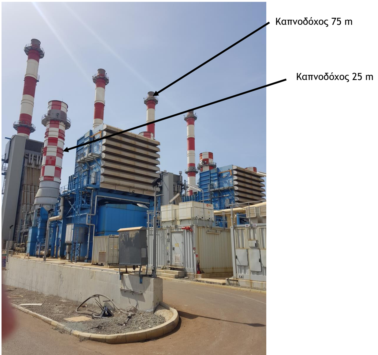
Εικόνα 5.8: Σύστημα καπνοδόχων των μονάδων ΑΣΚ
