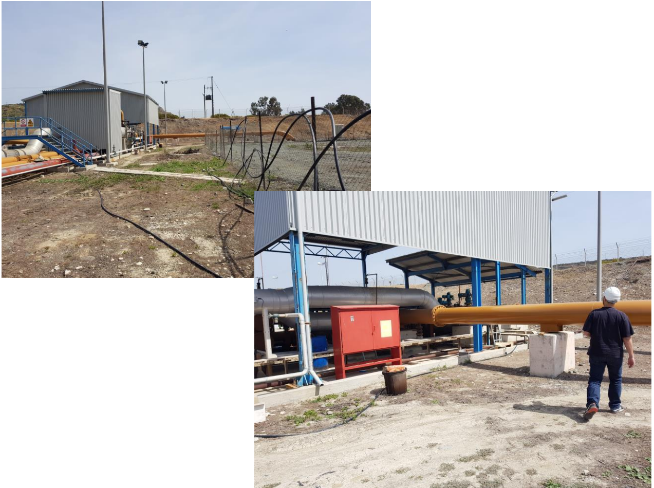
Εικόνα 5.19: Απόληξη στην ξηρά των δύο υποβρύχιων αγωγών μεταφοράς καυσίμων
