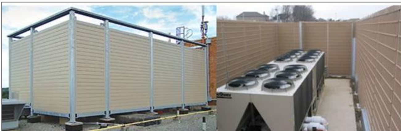
Εικόνα 9-9: Συστήματα VRV εντός ηχομονωτικής περίφραξης σε οροφή κτιρίου
