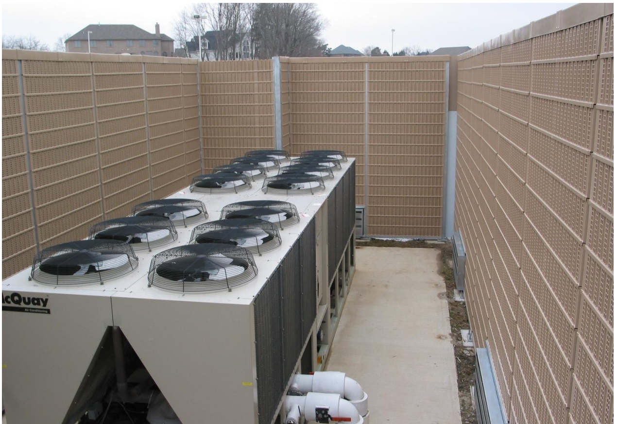
Εικόνα 9-8: Συστήματα VRV εντός ηχομονωτικής περίφραξης σε οροφή κτιρίου
