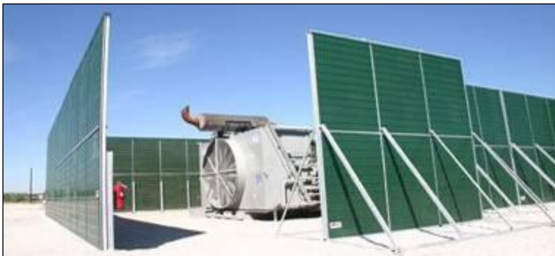
Εικόνα 9-1: Χρήση ηχοπετασμάτων σε σταθερές πηγές θορύβου
