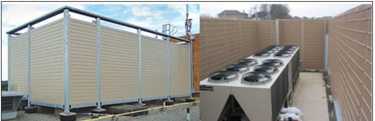
Εικόνα 9-7: Συστήματα VRV εντός ηχομονωτικής περίφραξης σε οροφή κτιρίου
