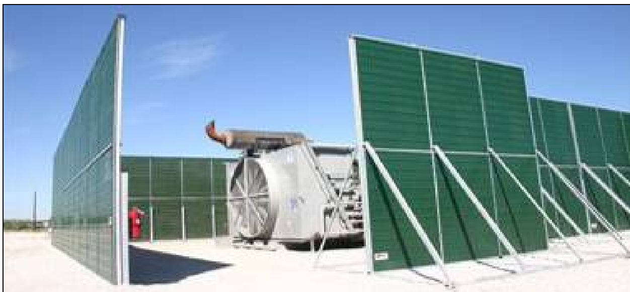
Εικόνα 9-2: Χρήση ηχοπετασμάτων σε σταθερές πηγές θορύβου
