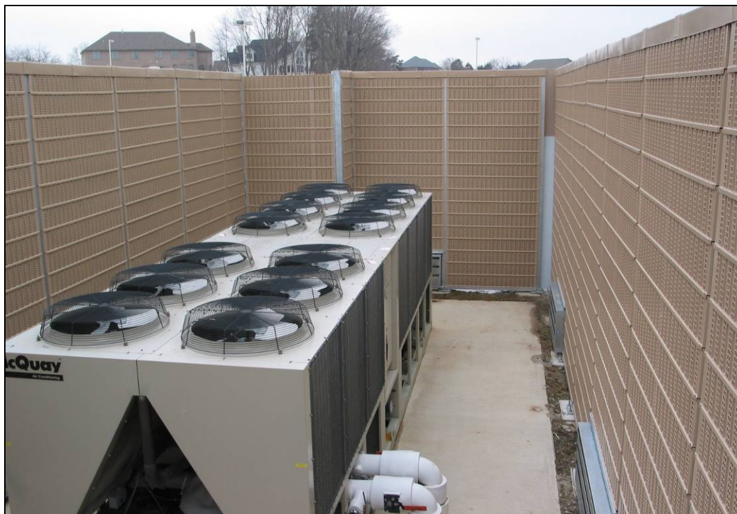
Εικόνα 9-6: Συστήματα VRV εντός ηχομονωτικής περίφραξης σε οροφή κτιρίου
