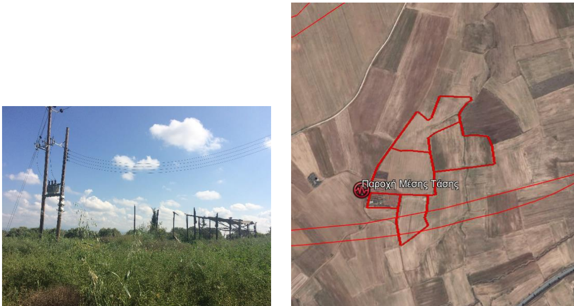
Φωτογραφία 2.2.5: Σημείο σύνδεσης στο δίκτυο της ΑΗΚ – Παροχή Μέσης Τάσης (στα όρια του τεμαχίου)
