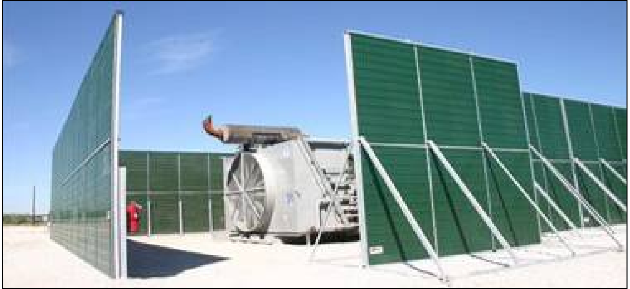
Εικόνα 9-2: Χρήση ηχοπετασμάτων σε σταθερές πηγές θορύβου
