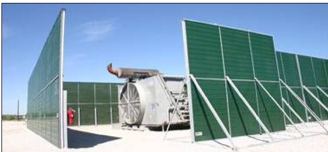
Εικόνα 9-1: Χρήση ηχοπετασμάτων σε σταθερές πηγές θορύβου
