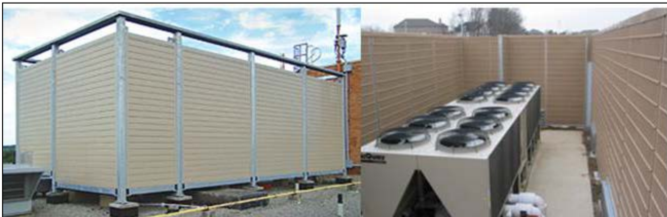
Εικόνα 9-7: Συστήματα VRV εντός ηχομονωτικής περίφραξης σε οροφή κτιρίου
