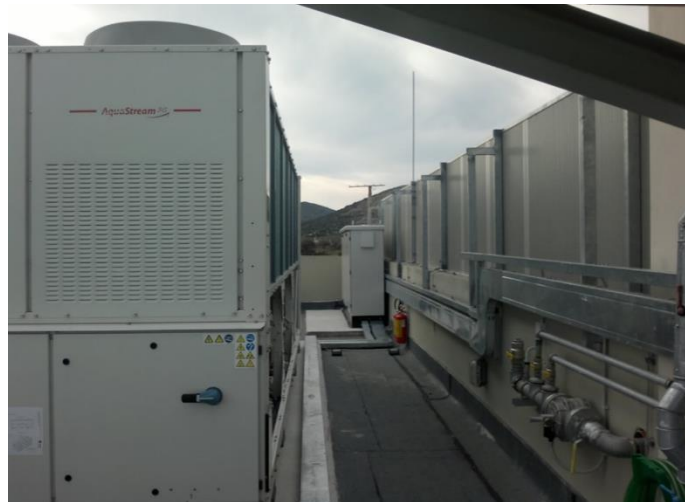
Εικόνα 7-2: Συστήματα VRV εντός ηχομονωτικής περίφραξης σε οροφή κτιρίου
