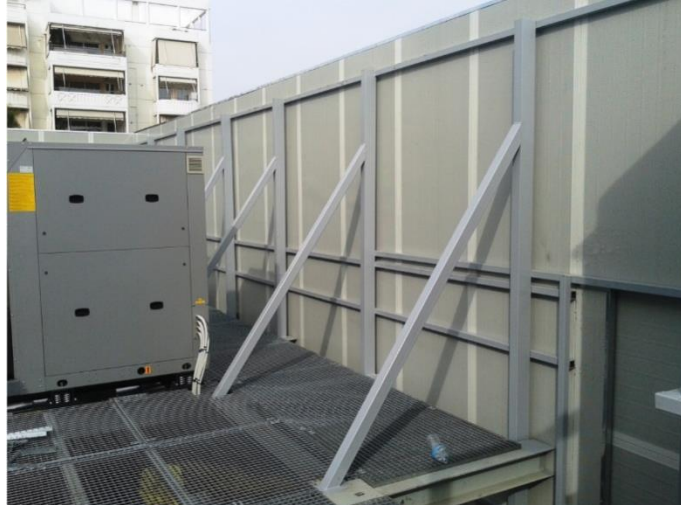
Εικόνα 7-3 : Συστήματα VRV εντός ηχομονωτικής περίφραξης σε οροφή κτιρίου
