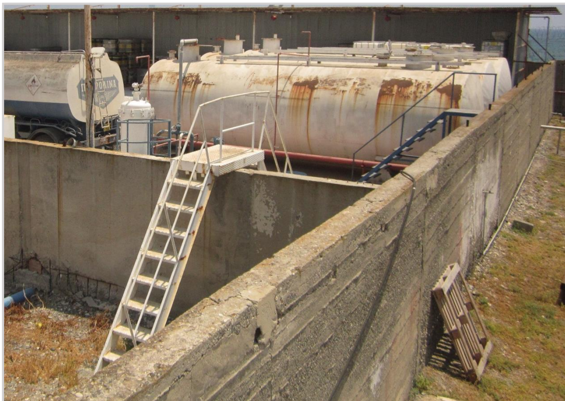
Εικόνα 3.8: Τοιμητένιες λεκάνες ασφαλείας περιμετρικά των δεξαμενών
