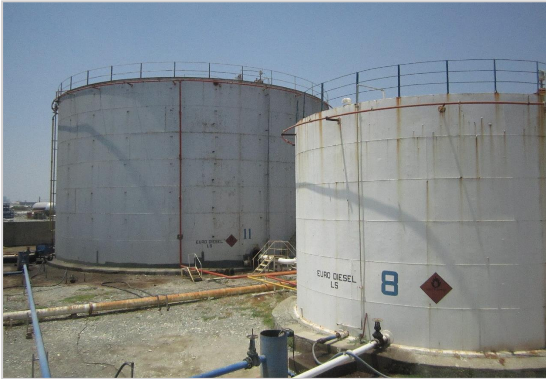
Εικόνα 3.7: Δεξαμενές αποθήκευσης Euro Diesel LS
