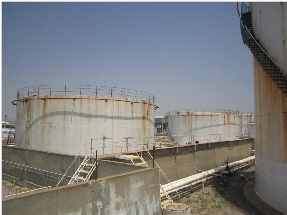
Εικόνα 3.6: Δεξαμενές αποθήκευσης πετρελαιοειδών - τσιμεντένιες λεκάνες ασφαλείας
