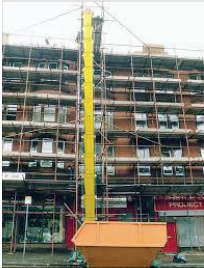
Εικόνα 9-6: Σωλήνας μεταφοράς σκουπιδιών (waste chute)
