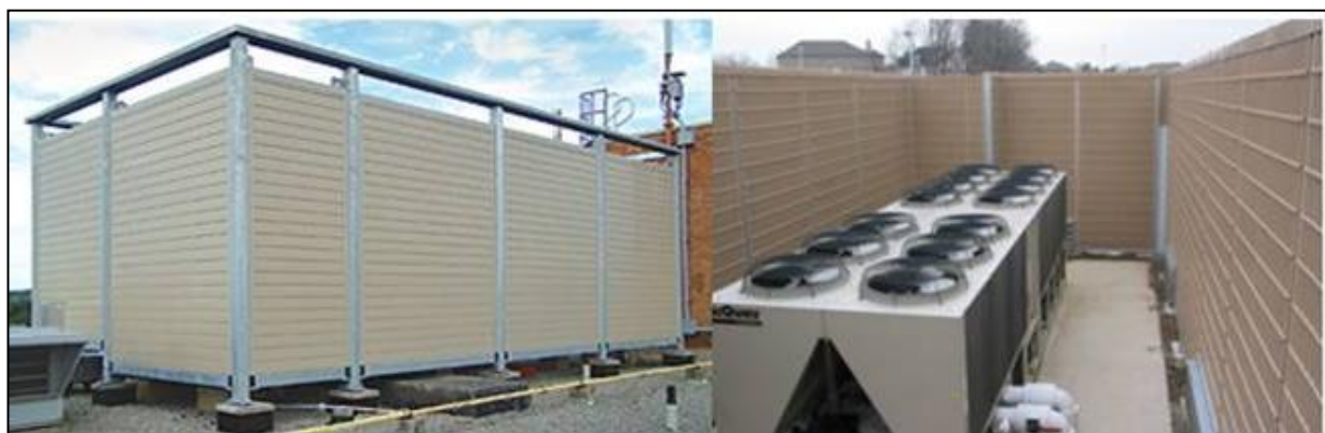
Εικόνα 9-7: Συστήματα VRV εντός ηχομονωτικής περίφραξης σε οροφή κτηρίου
