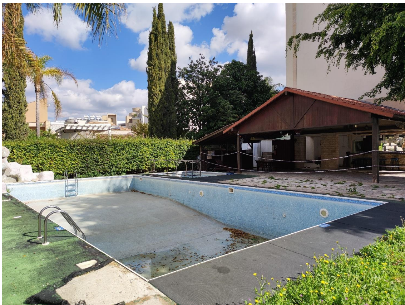
Φωτογραφία 6.2: Εγκαταλελειμμένες κολυμβητικές δεξαμενές υφιστάμενου ξενοδοχείου.
